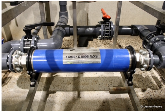
Das SKW-System im Wasserraum bei Gipmans Pflanzen
